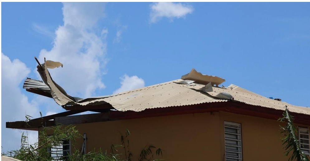
Faîtières et bandes de rives soulevées sur un toit à quatre pentes
